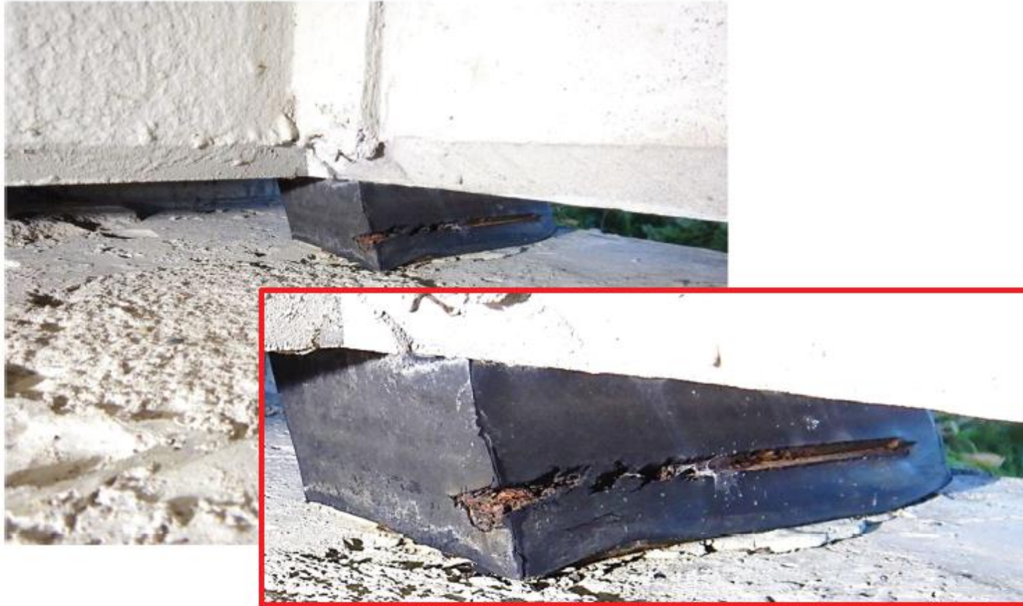
Bild 24: Frontansicht 1. Lager von Süden; WL Ost; Elastomerkissen zerrissen, Bewehrungsplatte korrodiert
