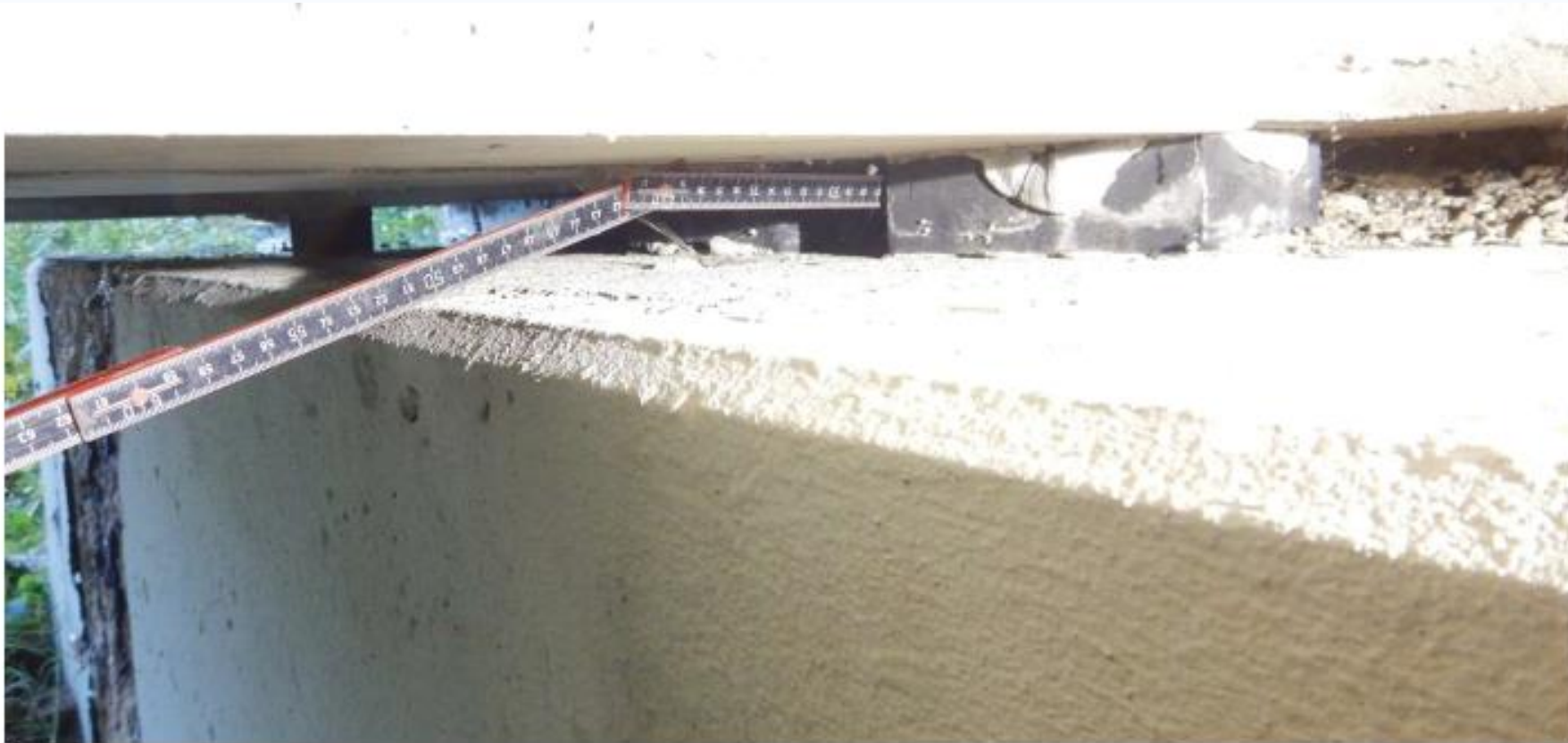
Bild 28: Ansicht 8. Lager von Süden, WL Ost, nahezu keine Verschiebung, Elastomerkissen um die Hochachse ca. 2 cm verdreht
