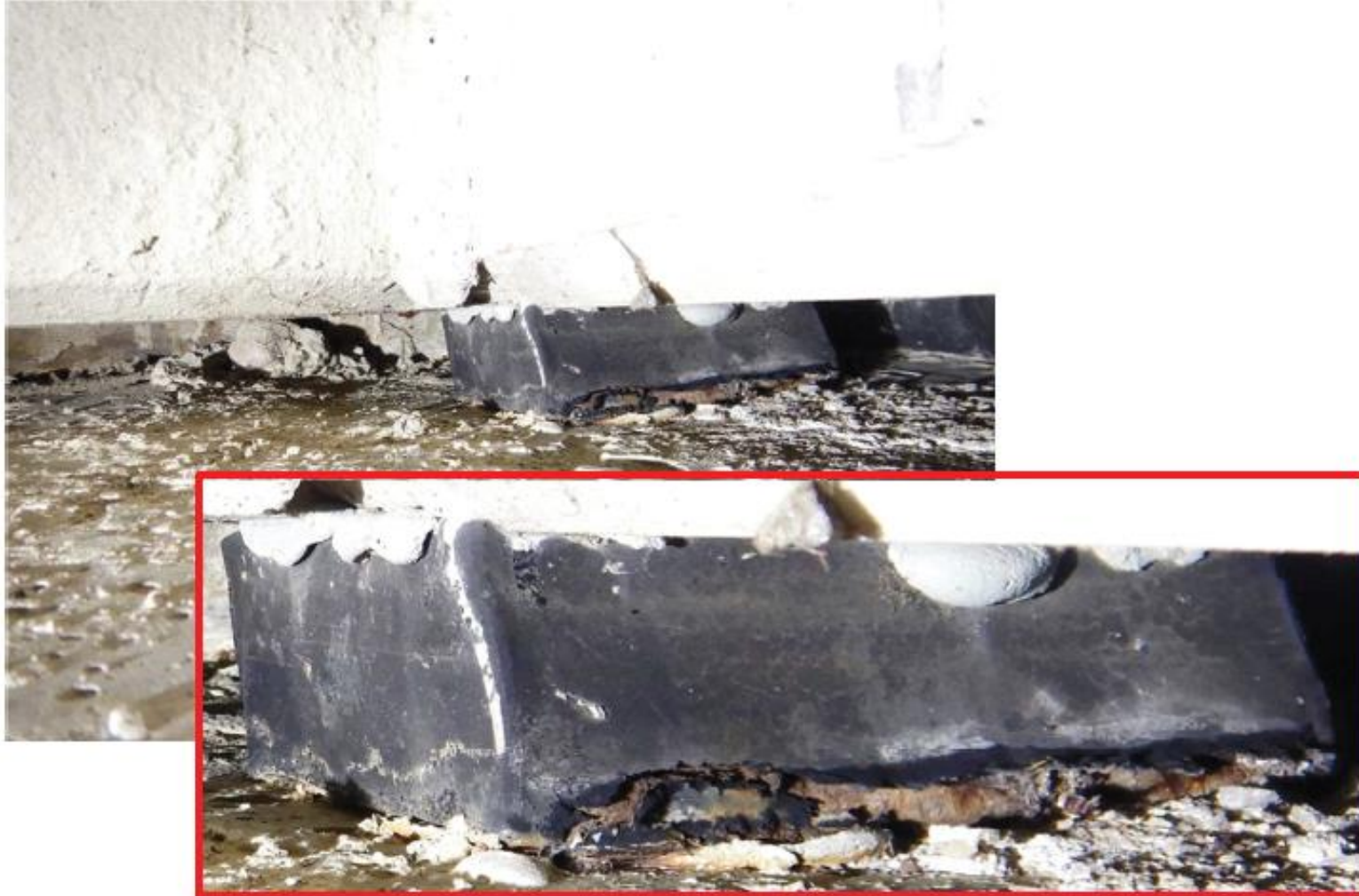
Bild 25: Frontansicht 3. Lager von Süden, WL Ost, Elastomerkissen zerrissen, Bewehrungsplatte korrodiert, Verschiebung ca. 14 mm (2. und 3. Lager)
