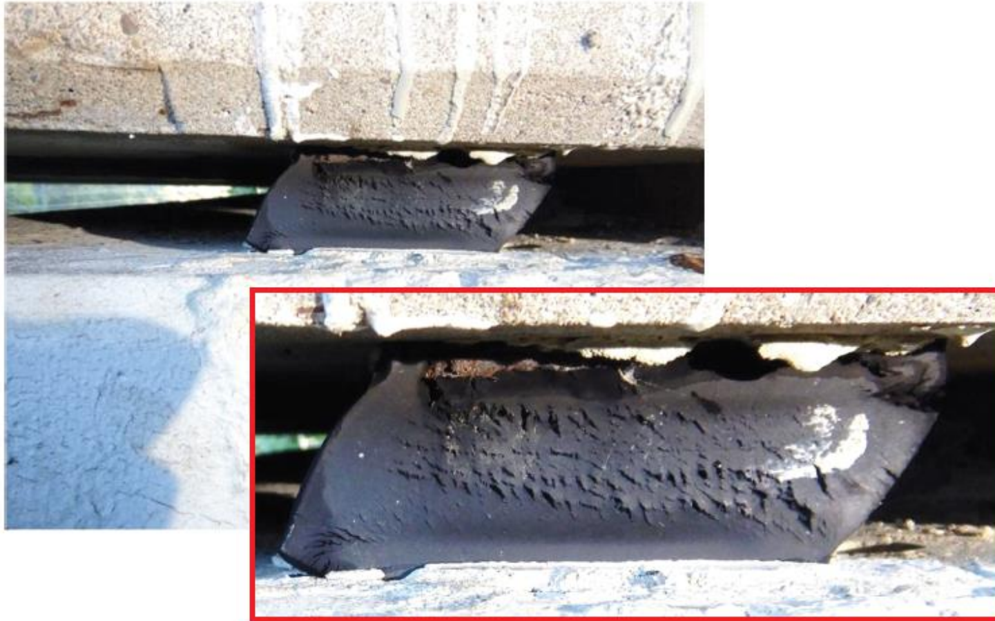
Bild 23: Seitenansicht 1. Lager von Süden; WL Ost; starke Verschiebung (ca. 21 mm => max. zul. Verschiebung Typ 5: 14 mm bei Kissenhöhe 46 mm => Überlastung), Elastomer gerissen
