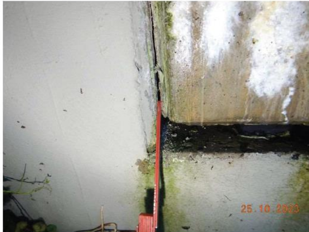
Bild 29: Ansicht keilförmiger Spalt (unten ca. 7 mm, oben 0 mm) zwischen Überbau und Flügelwand, WL Ost, Norden; massive Aussinterungen und Wasserlaufspuren zwischen FT-Kappe und Überbau
