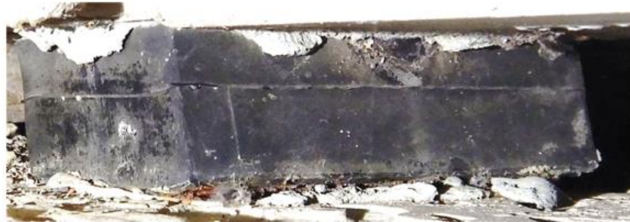
Bild 26: Frontansicht 4. und 5., Lager von Süden, WL Ost, Elastomer gerissen, Bewehrung korrodiert, Verschiebung ca. 10 mm
