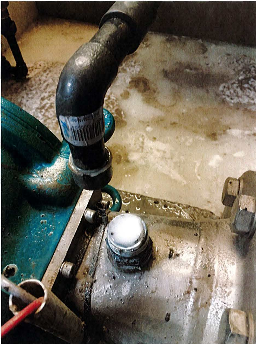
Abbildung 3: Geplatzte Leitung der Zudosierung des Flockungshilfsmittels während der Beschickung am 04.08.2021. Aufgrund eines fehlenden Rückschlagventils konnte Klärschlamm in die Wasserleitung eindringen und die Leitung verstopfen. Nach einem Druckstoß brach schließlich die PVC-Leitung direkt oberhalb des Gewindes an der Klärschlammpumpe.
