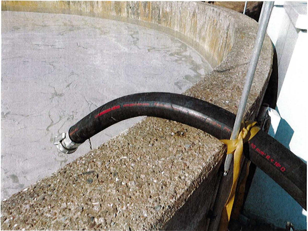
Abbildung 2: Befüllung des Stapelbehälters mit Kreideslurry am 08.03.2021. Als Klärschlamm/Kreide-Gemisch wurde damit Beet 3 beschickt, um das Entwässerungsverhalten zu verbessern.
