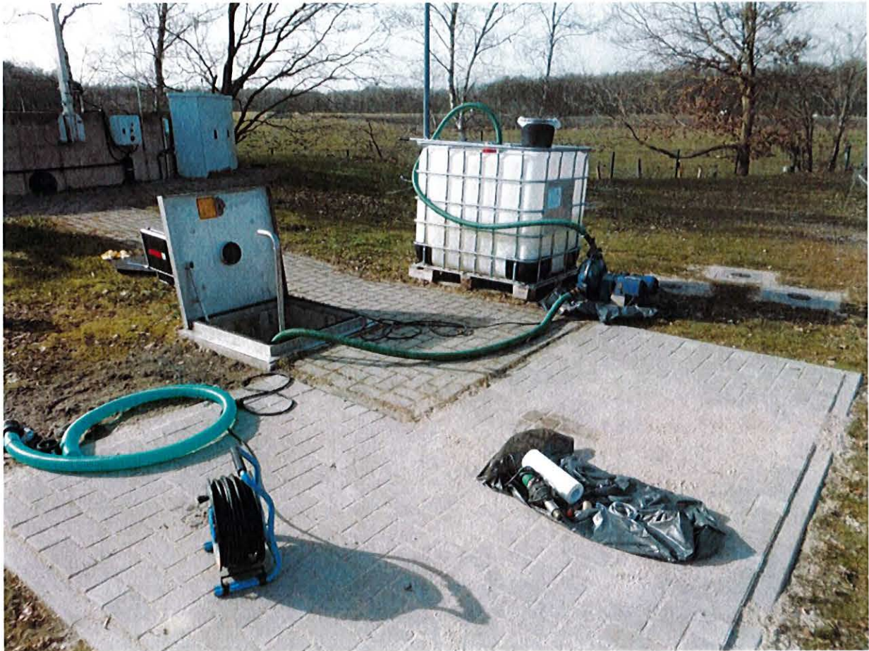
Abbildung 1: Am 23.02.2021 wurde das alte Flockungshilfsmittel, das Verklumpungen aufwies, mit Hilfe einer Schlauchpumpe in den IBC zurückgepumpt. Die Wiederbefüllung wurde am 03.03.2021 mit neuem, einwandfreiem Flockungshilfsmittel durchgeführt.
